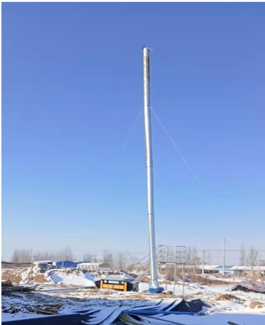
图 4-1 污水处理站排气筒
