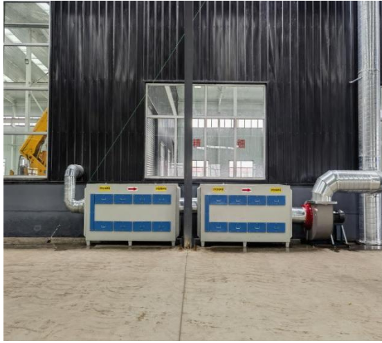
图 3-1 活性炭吸附装置+15m 排气筒
