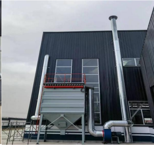
图 3-2 布袋除尘器+15m 排气筒
